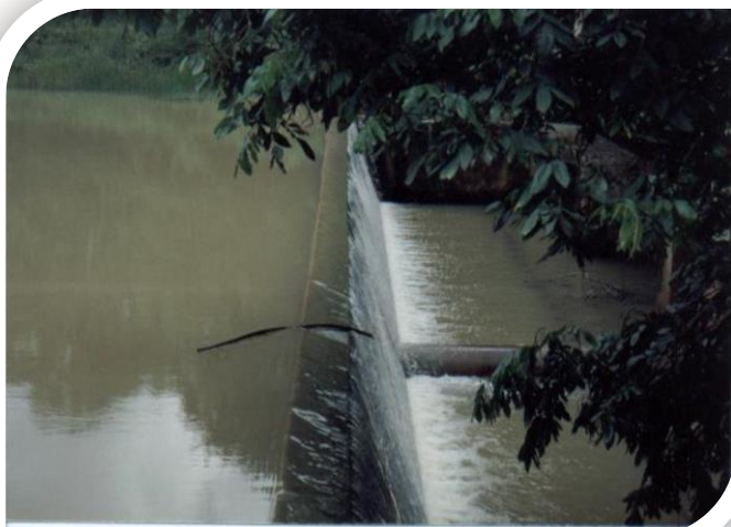
Barragem de Nível no Rio Utinga
