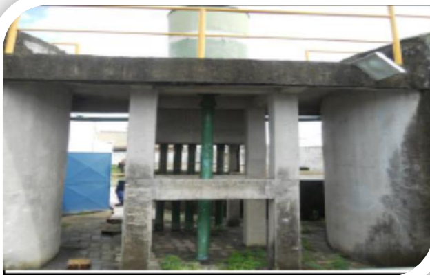
Caixa de Distribuição
