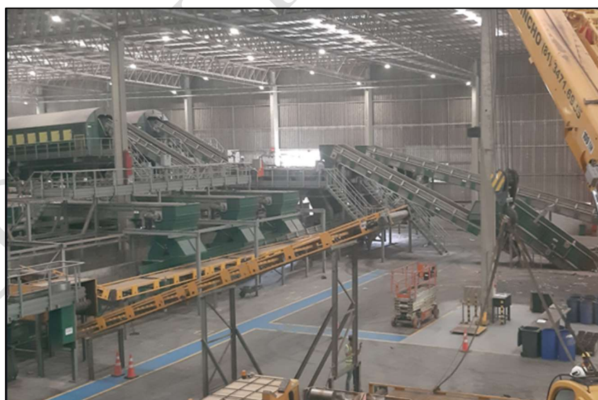
Figura 45: UTM: planta de triagem mecanizada
